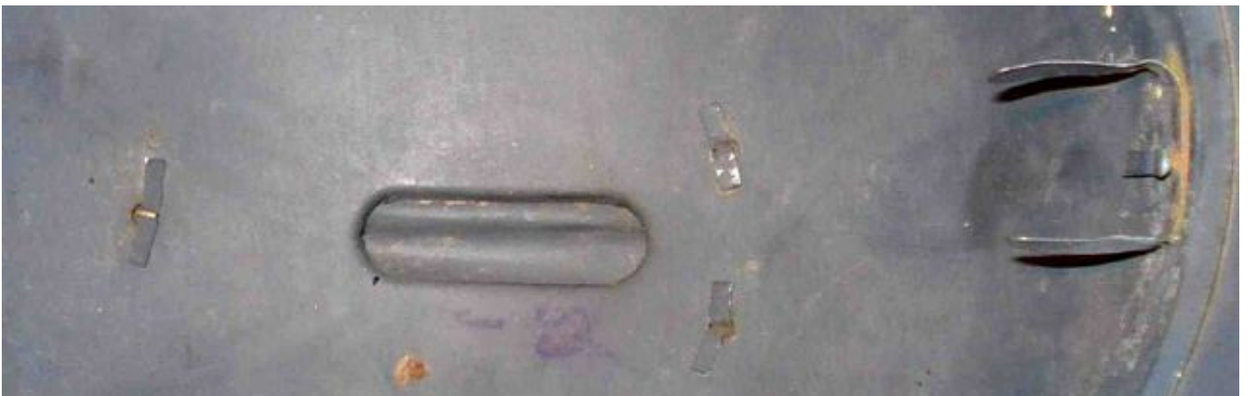
Раскрытые заклепки гребня, вид изнутри (JAPY).
